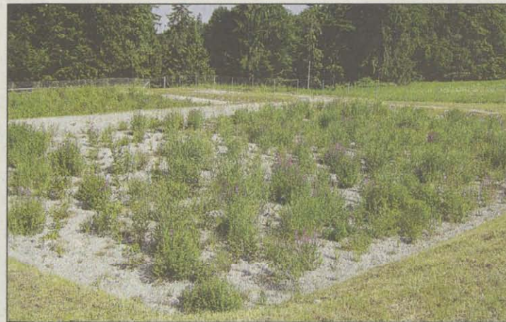
Auf den ersten Blick unspektakulär, aber effektiv: Die 12 000 Pflanzen umfassende Filterschicht reinigt das Abwasser preisgünstiger als herkömmliche Anlagen. FOTO GEMEINDE ROTTENBUCH
