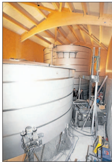
Moderne Trinkwasserspeicheranlagen bestehen aus Edelstahl. FOTO BSZ
