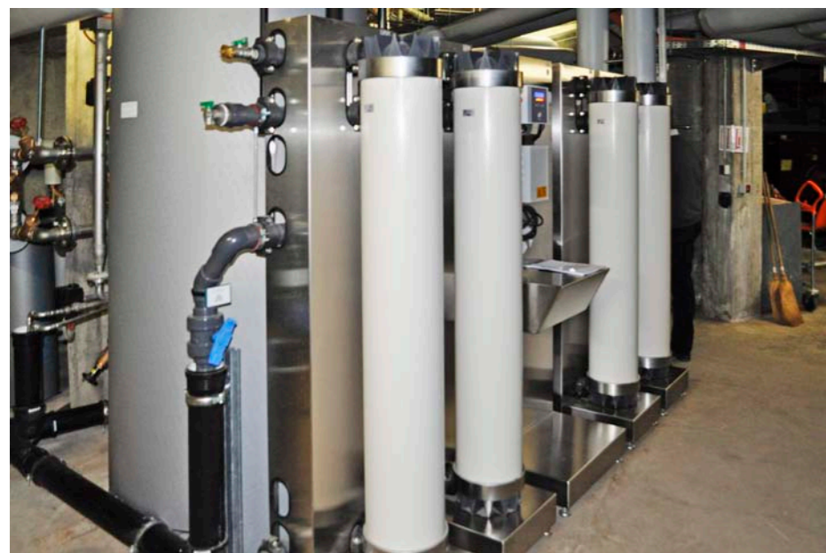
Ultrafiltrationsanlage am Hauswassereingang
