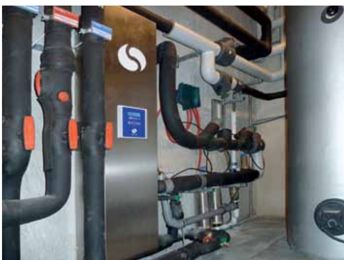
Seccua Filtrationsanlage in einem Mehrfamilienhaus
